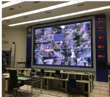
ศูนย์ควบคุมจราจร บกจร.02
