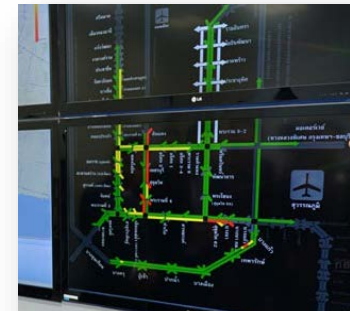
ศูนย์ควบคุมทางพิเศษด้วย ITS Center
